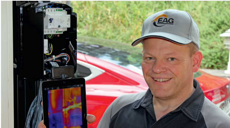
Matthias Güldner nutzt die FLIR ONE Pro regelmäßig im Arbeitsalltag – hier zum Thermografieren einer Kfz-Ladestation während des Ladevorgangs.
